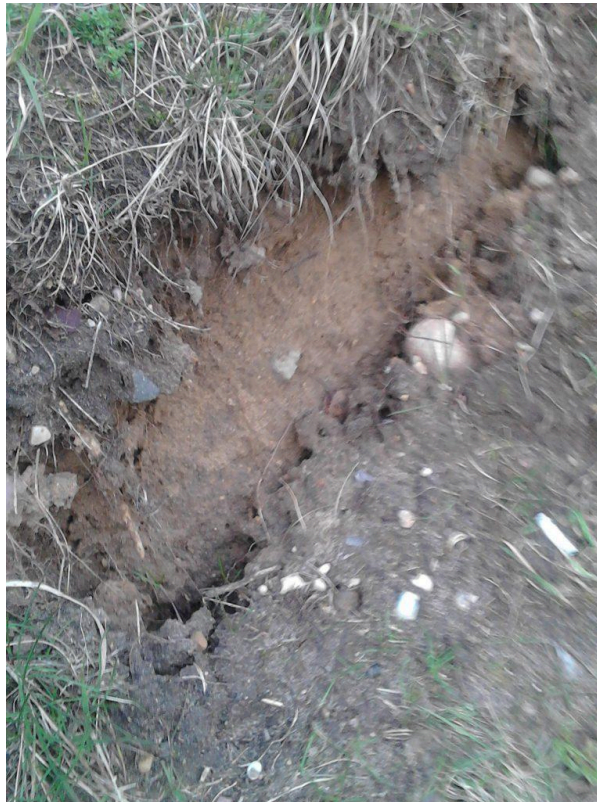
Trijų kryžių kalne formuojasi nuošliauža | Deivydo Jonelio nuotr.
